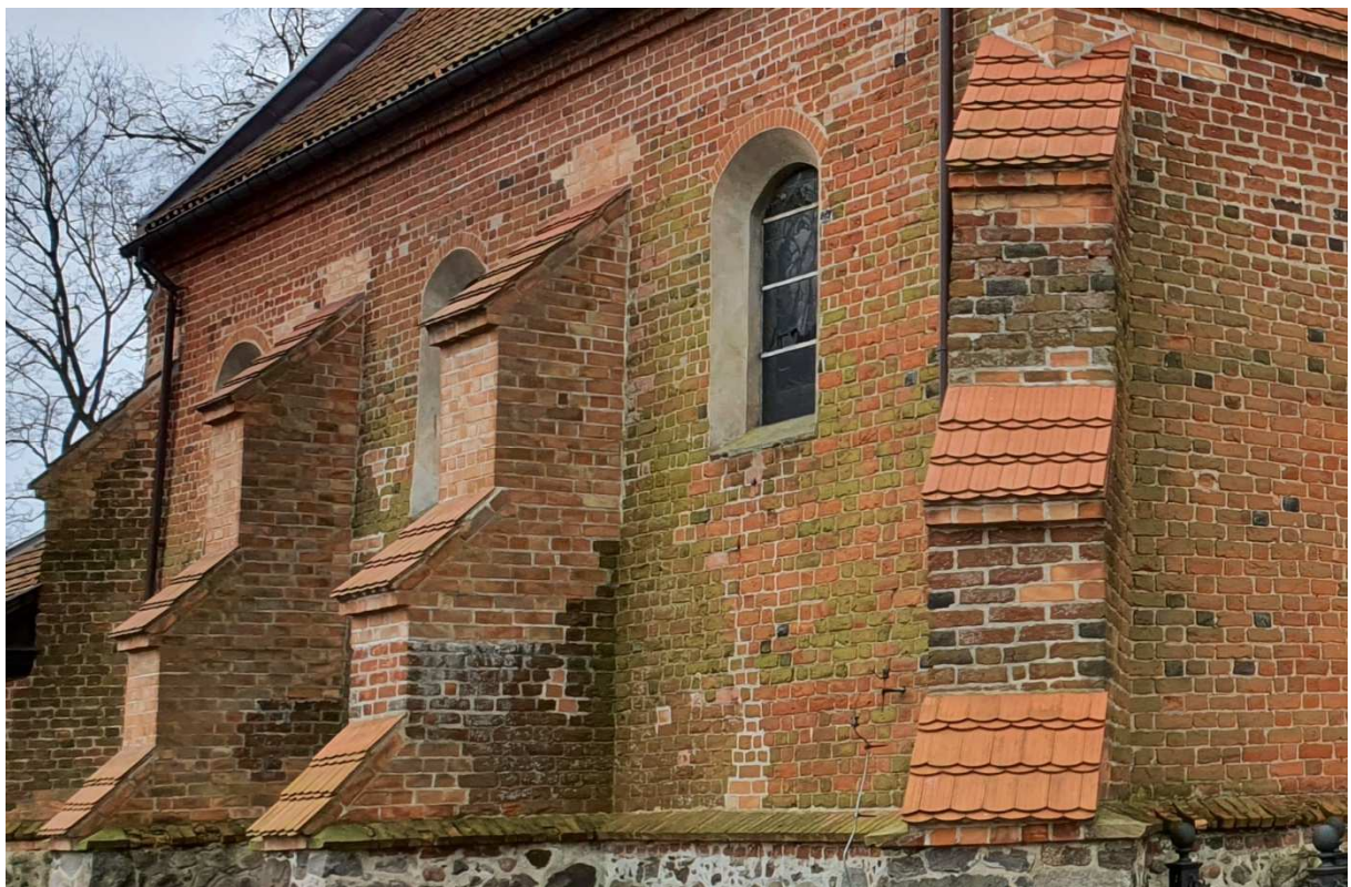
Fot.14. Grodziczno, kościół pw. św. Piotra i Pawła, elewacja północna. Na zdjęciu zakres napraw murarskich oraz aktualny sposób zabezpieczenia spływów przypór.
