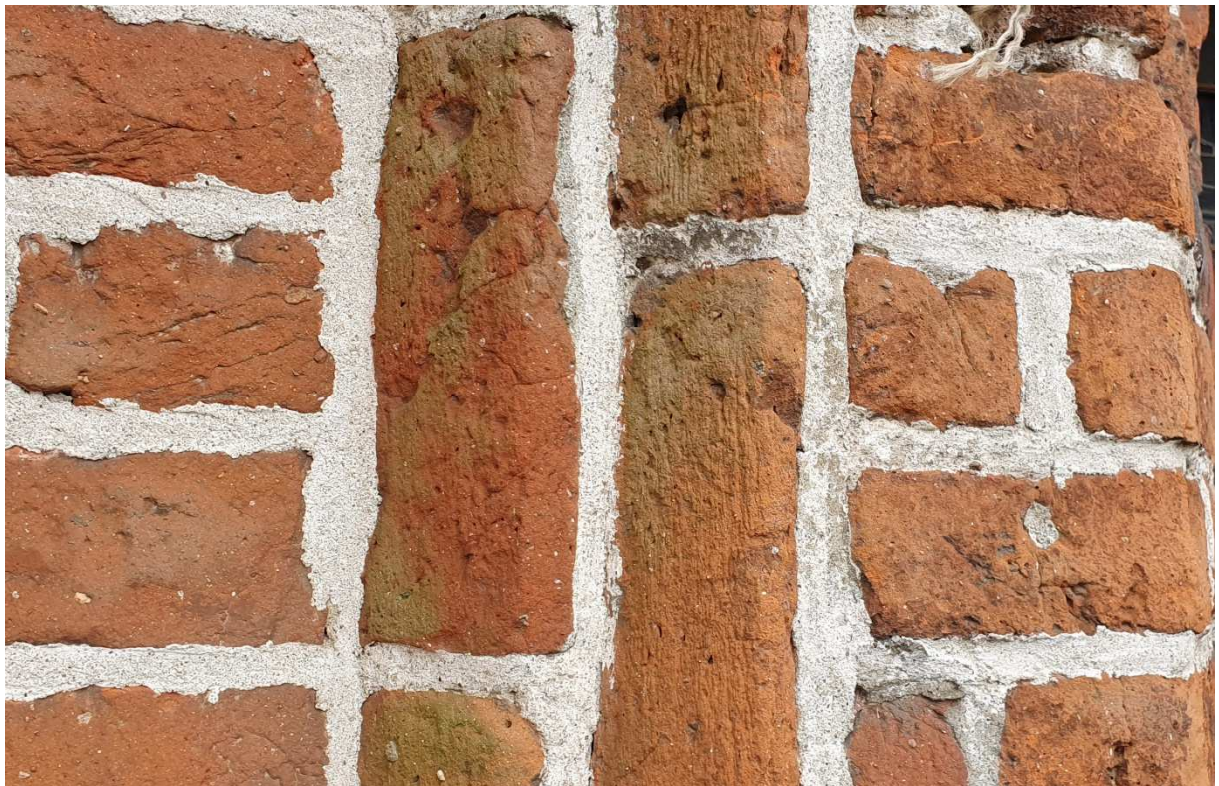
Fot.16. Grodziczno, kościół pw. św. Piotra i Pawła, fragment wątku ceglanego z XX-wieczną spoiną cementową.
