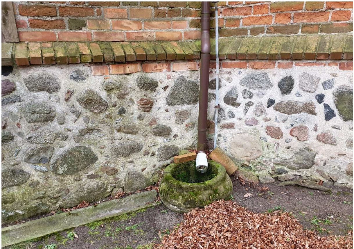
Fot.12. Grodziczno, kościół pw. św. Piotra i Pawła, elewacja północna. Na zdjęciu widoczny szczelnie wyspoinowana cokołowa część budynku. Odprowadzenie wody opadowej wymaga uporządkowania.
