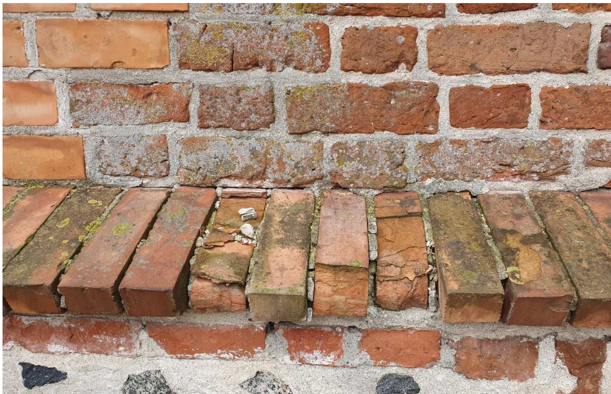
Fot.9. Grodziczno, kościół pw. św. Piotra i Pawła, elewacja północna. Fragment parapetu cokołu z widocznymi uszkodzeniami pochodzenia solnego. Na zdjęciu widoczne także nawarstwienia biologiczne w postaci kolonii szarych porostów kalcytofilnych.
