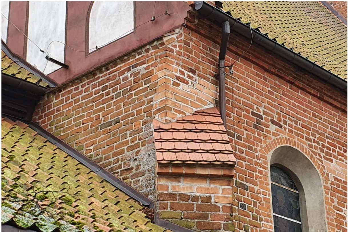
Fot.13. Grodziczno, kościół pw. św. Piotra i Pawła, północno-wschodni narożnik budynku. Naprawy wątku ceglanego wykonano cegłą o nietrafionej kolorystyce, zbyt jasną i o zbyt gładkiej powierzchni.
