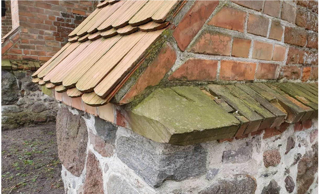
Fot.11. Grodziczno, kościół pw. św. Piotra i Pawła, elewacja północna, fragment parapetu cokołu. Na zdjęciu ciekawy narożny element z piaskowca. Kamień został w całości przeszlifowany z użyciem współczesnych elektronarzędzi.
