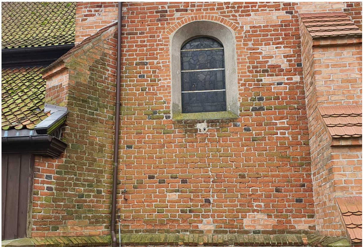
Fot.8. Grodziczno, kościół pw. św. Piotra i Pawła. Elewacja północna kościoła w partii korpusy. Na zdjęciu widoczne pionowe spękanie muru, zlokalizowane pod parapetem okna.
