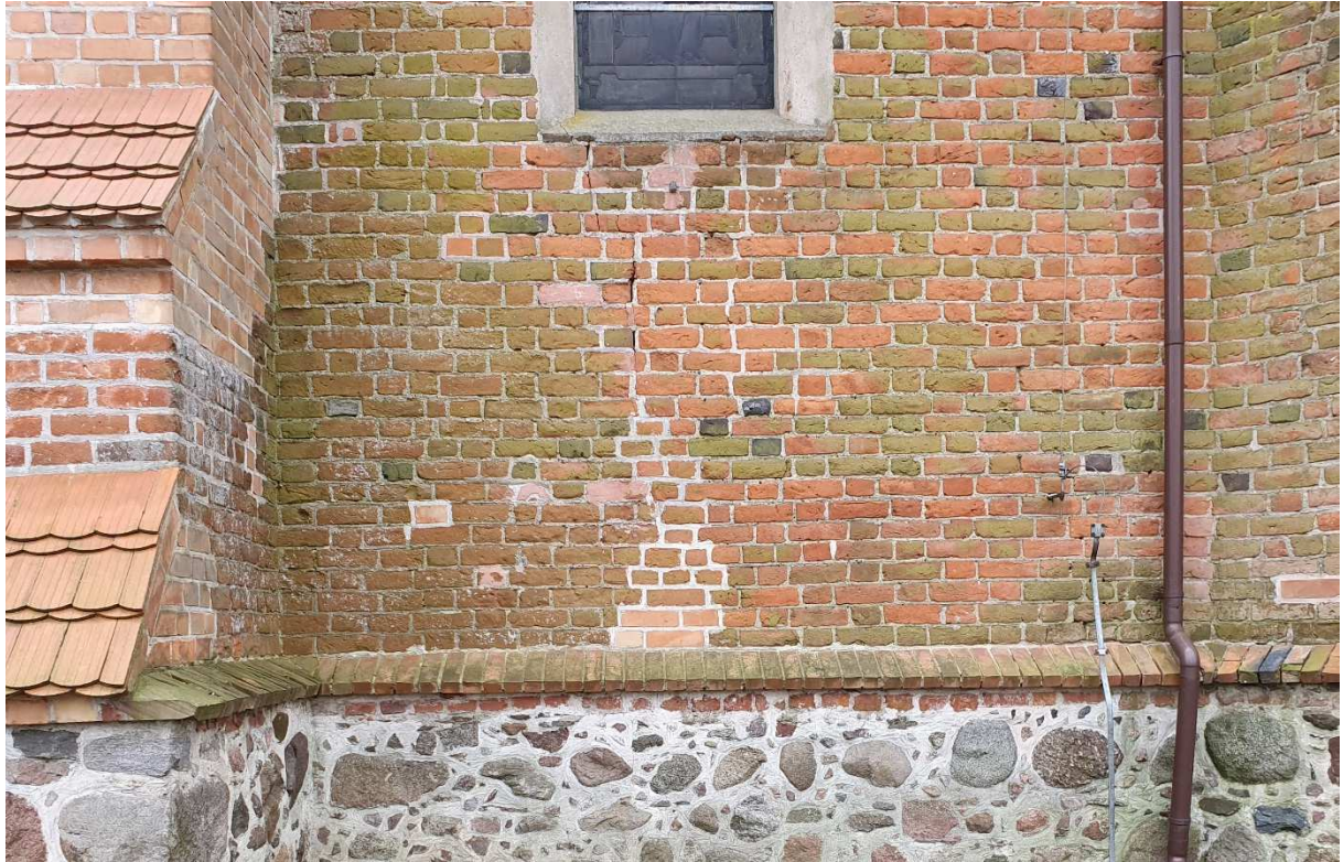
Fot.7. Grodziczno, kościół pw. św. Piotra i Pawła. Elewacja północna kościoła w partii korpusy. Na zdjęciu widoczne pionowe spękanie muru.
